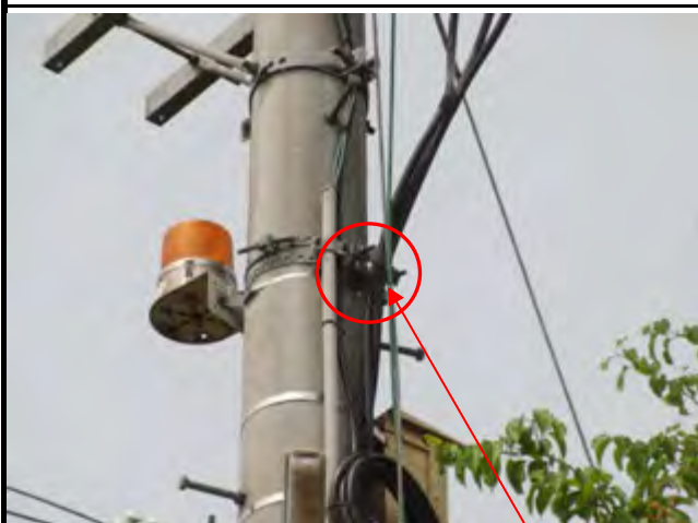
ケーブルがサドルに引っかかっている
