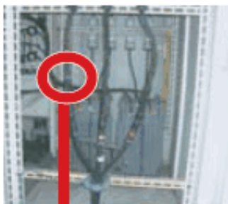
高圧ケーブル
