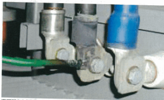
変圧器2次側端子接続部の過熱箇所
