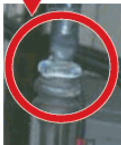
高圧ケーブル青相端末に変色あり
