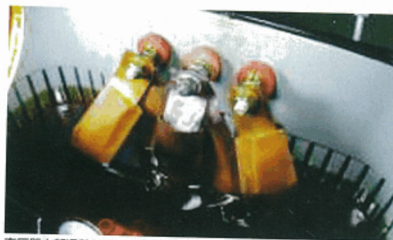
変圧器内部過熱による変色状態
