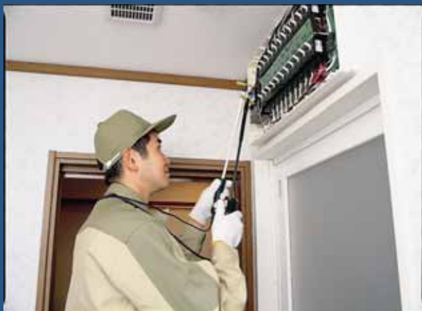
分電盤で、絶縁抵抗の測定
