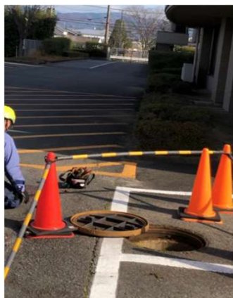
マンホールの蓋が裏返った状態
