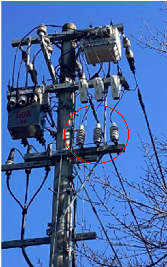
【高圧回路に避雷器の設置】
