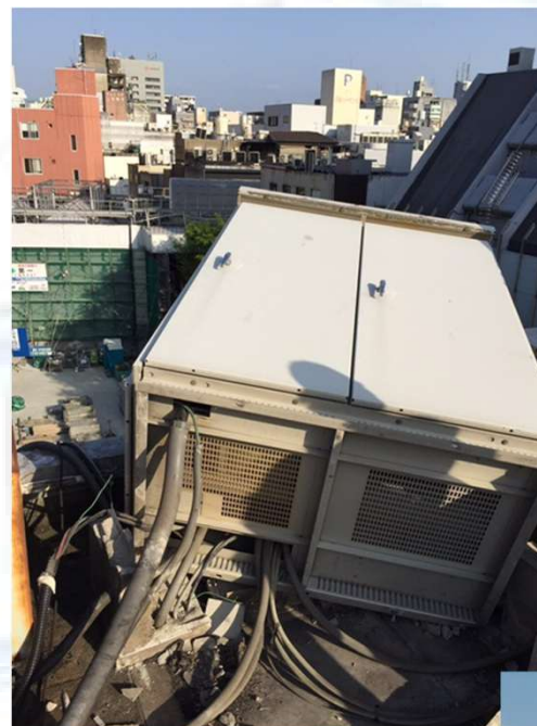
【地震による被害を受けた変電設備】
