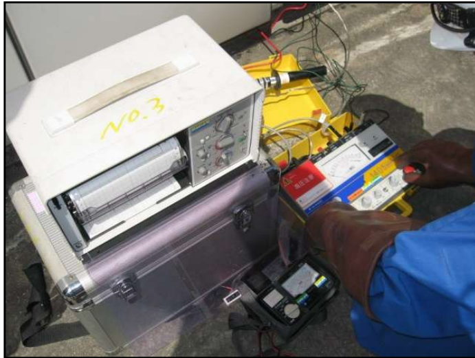
【高圧CVケーブルの精密点検】
