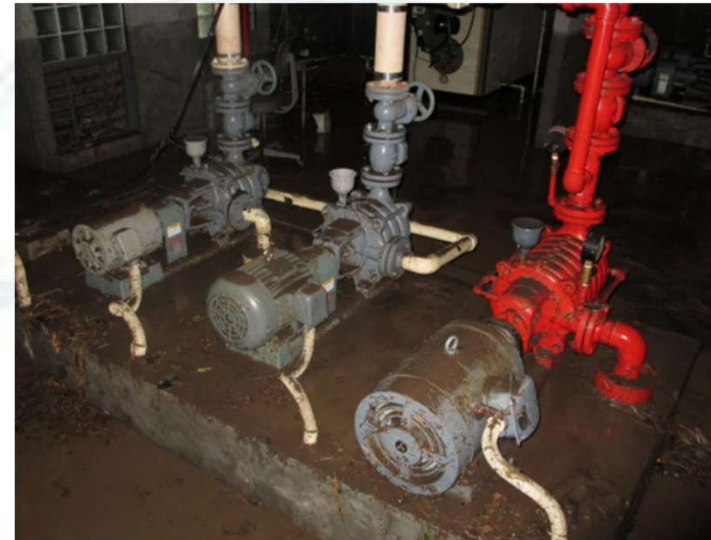
【洪水による被害を受けた電動機】
