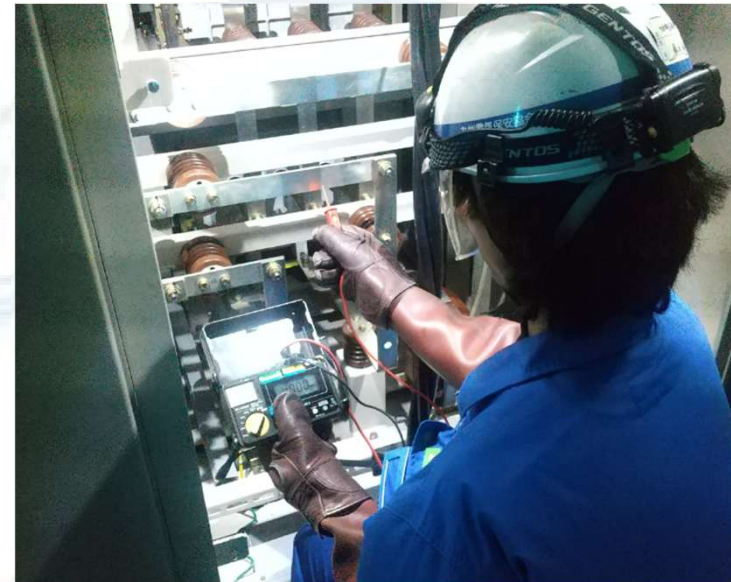
【電気回路の絶縁抵抗測定】
