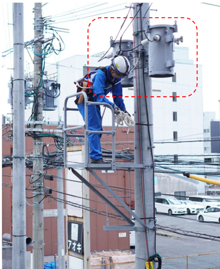
【電柱上に設置された需要設備】
