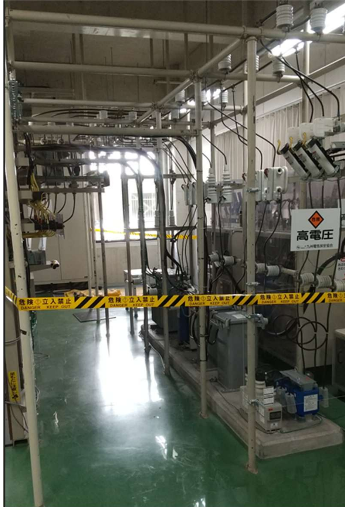
【オープンフレーム式需要設備】
