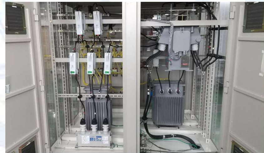
【キュービクル式需要設備(裏)】
