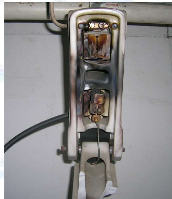
経年劣化したヒューズの焼損
