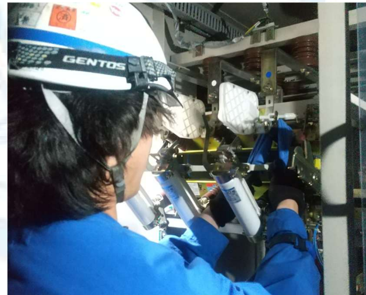
【電気機器の点検・清掃】
