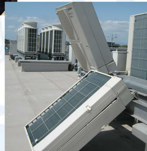
【地震による被害を受けた空調室外機】
