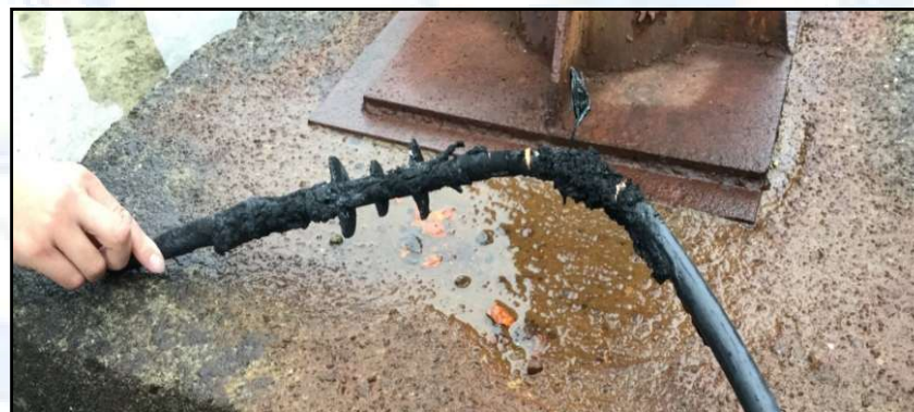
高圧CVケーブル絶縁破壊(焼損)
