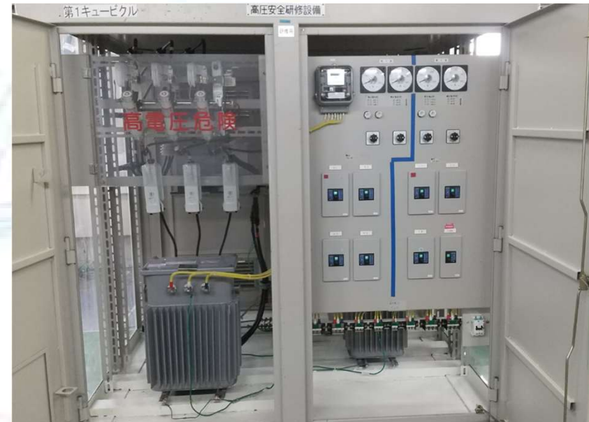
【キュービクル式需要設備(表)】
